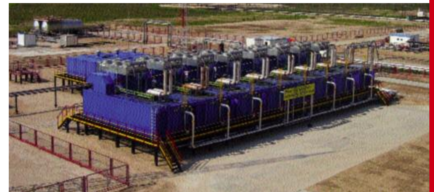
Central elétrica de Bashneft, Sibéria Central
